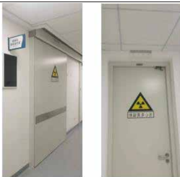
满足屏蔽要求的机房防护门
